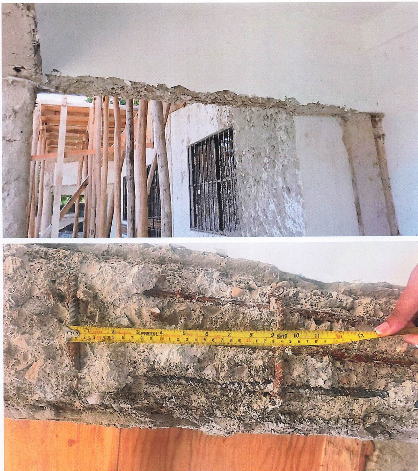
Fig. 8: Evidencia de remoción de recubrimiento en diversos componentes constructivos- Funeraria Municipal de Montellano, Montellano, Puerto Plata, Rep. Dom.
