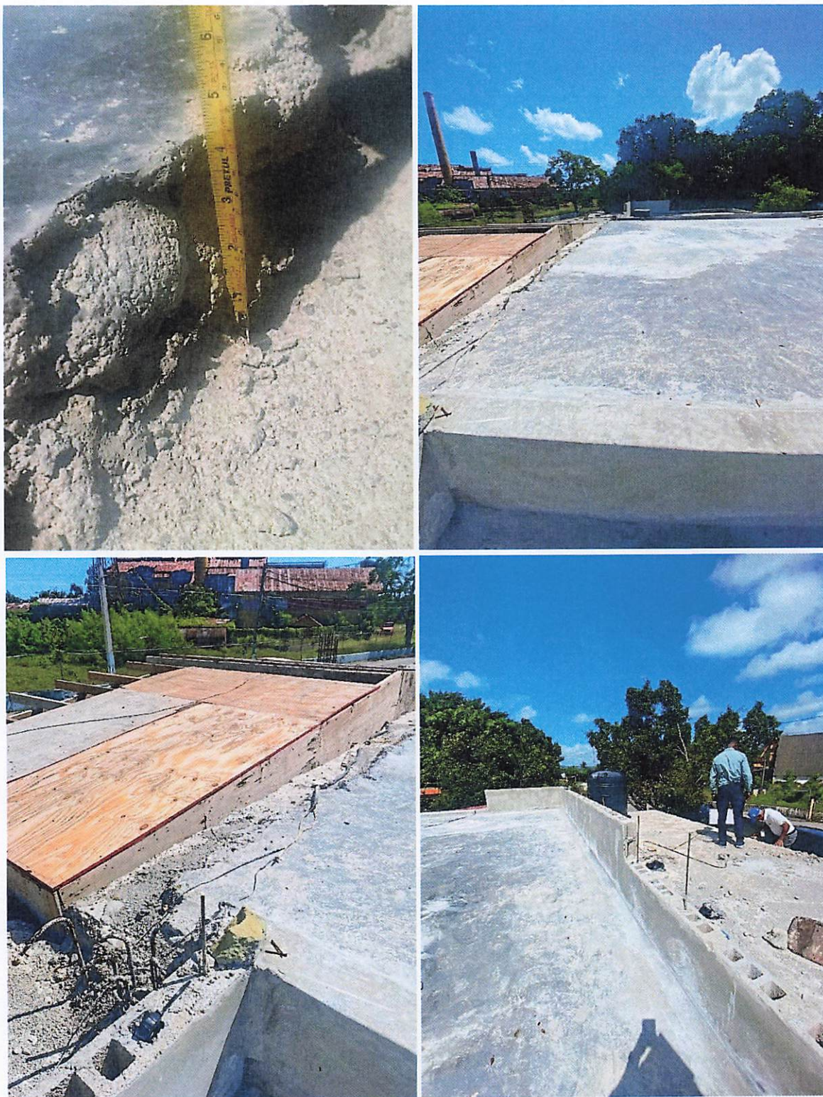
Fig. 13: Evidencia de que fue colocado un fino de 11cm sobre losa deflectada - Funeraria Municipal de Montellano, Montellano, Puerto Plata, Rep. Dom.
