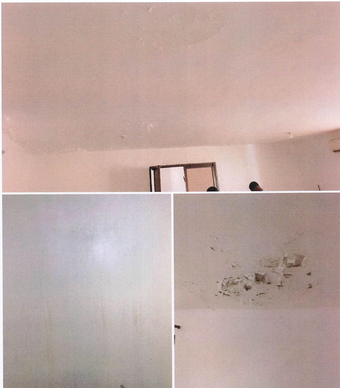
Fig. 12: Filtraciones en muros y losa de techo por posible deficiencia de sistema de desagüe pluvial y falta de impermeabilizante - Funeraria Municipal de Montellano, Montellano, Puerto Plata, Rep. Dom.
