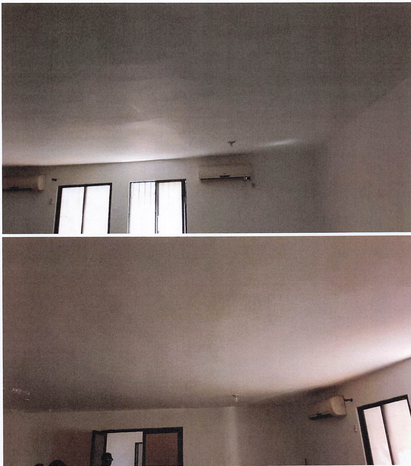
Fig. 9: Evidencia de pandeo en losa de techo de anexo utilizado como sala de velatorio- Funeraria Municipal de Montellano, Montellano, Puerto Plata, Rep. Dom.
